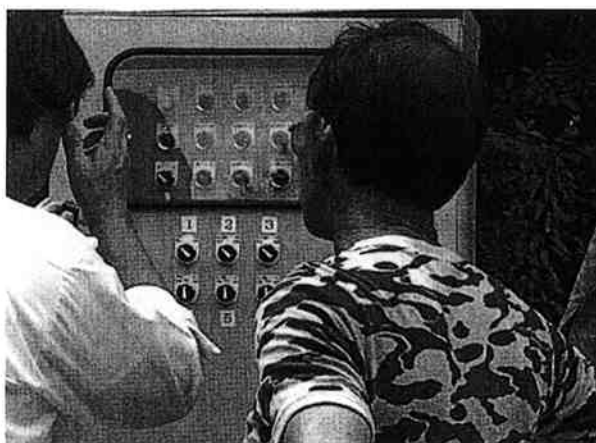
写真5 生ゴミ用焼却炉のコントロール板
