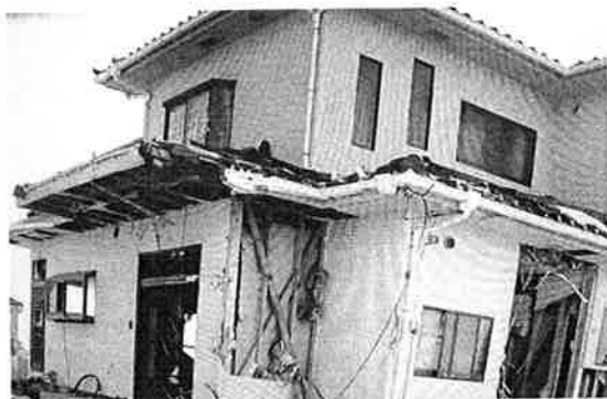
写真2 津波で破壊された家
